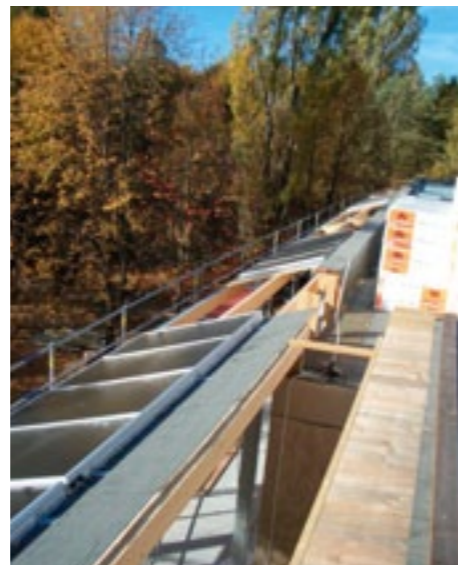
Abb. 3.1.5 Solarkollektoren fangen Sonnenlicht und -wärme für den eigenen Energiebedarf ein.
