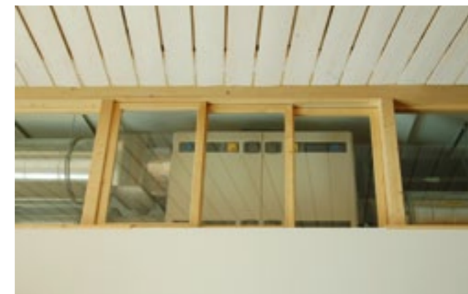
Abb. 3.1.2 Transparente Bauweise: Hinter Glas ist die Lüftungsanlage zu erkennen.
